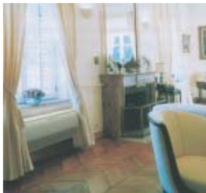
Jednostka wewnętrzna zlokalizowana pod oknem (fot. Daikin Poland)
