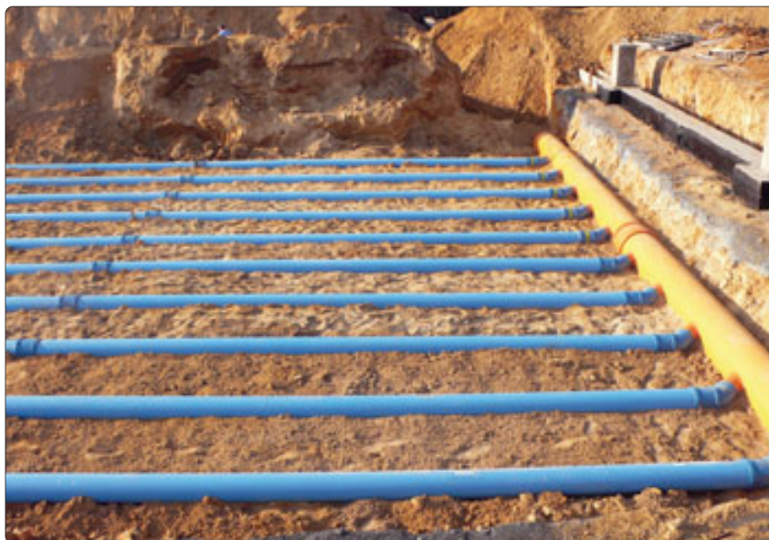
Fot. Gruntowy wymiennik ciepły AWADUKT Thermo w centrum handlowym Tesco w Zdziesszowicach, woj. opolskie.
